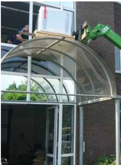
Teststation LH auf dem Weg in das Gebäude
